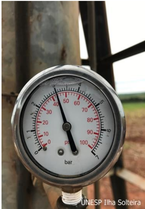
Figura 7- Pressão no centro do pivô e no final do pivô.
