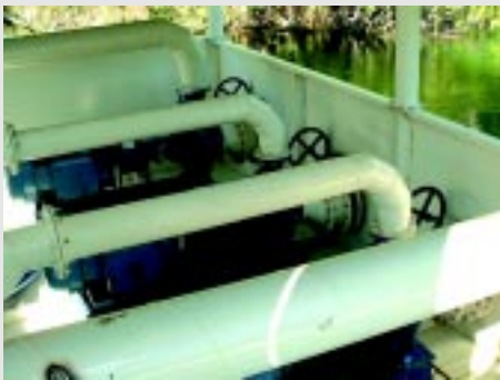
Estação elevatória; captação de água do rio
